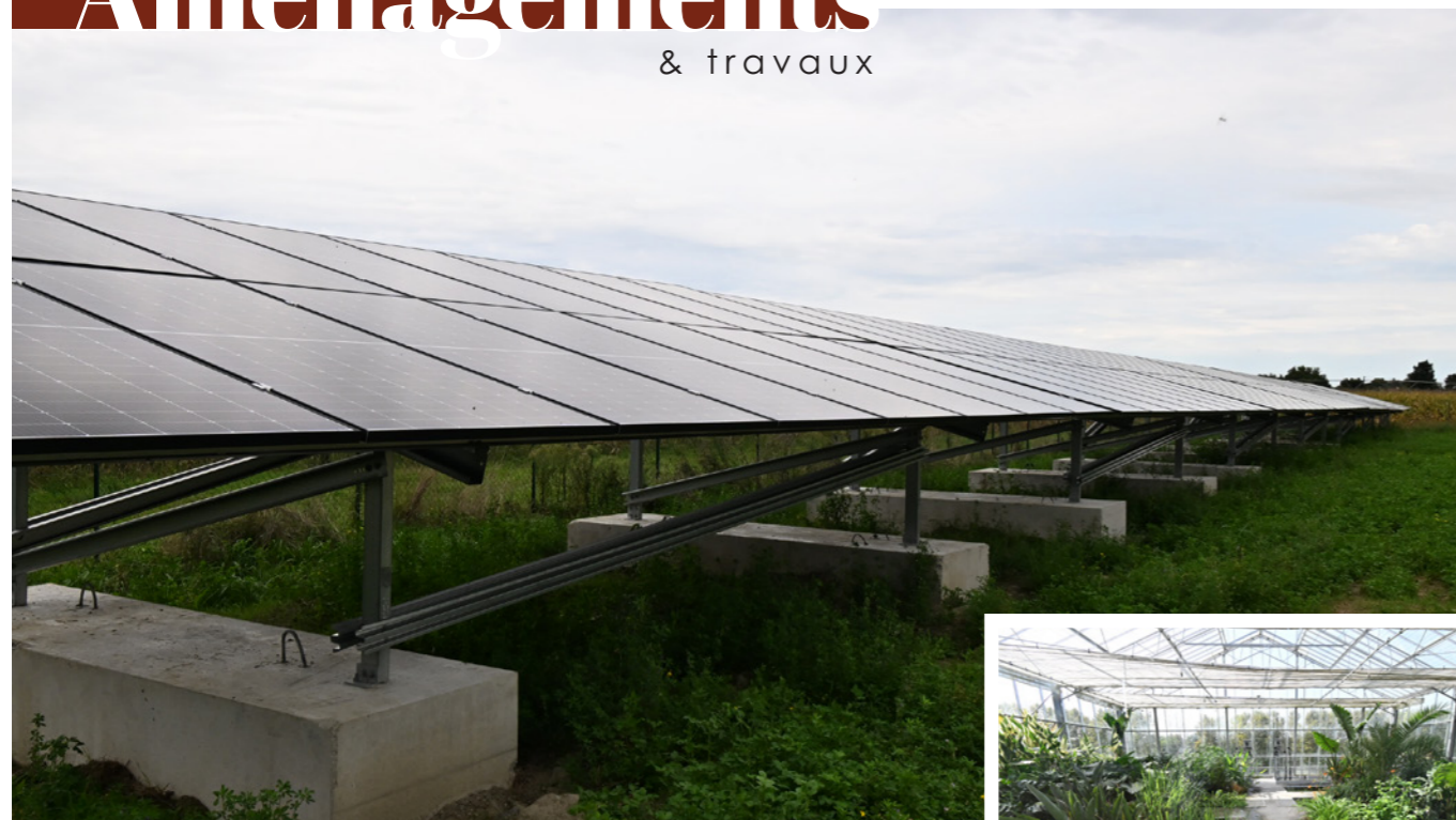
Les panneaux photovoltaïques - Station d'épuration
